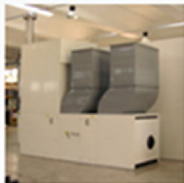
Ventilatiegroep met rechthoekige kanalen ; wit gelakt ; geïsoleerd ; enz... Groupe de ventilation avec gaines rectangulaires ; peint en blanc ; isolé ; etc...
